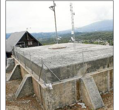
L'actual dipòsit de la urbanització.
