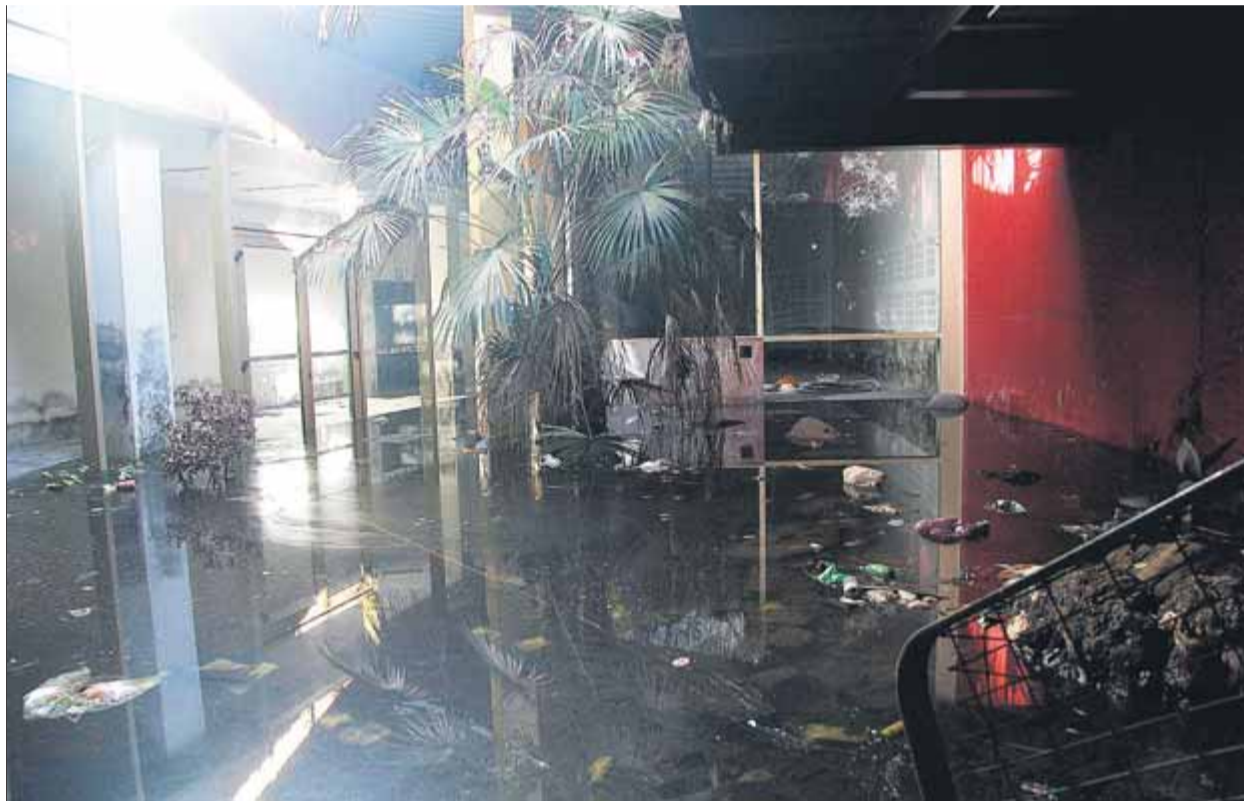
L'accés al saló de banquets, inundat parcialment per les aigües freàtiques ■ DANI GRADOS
