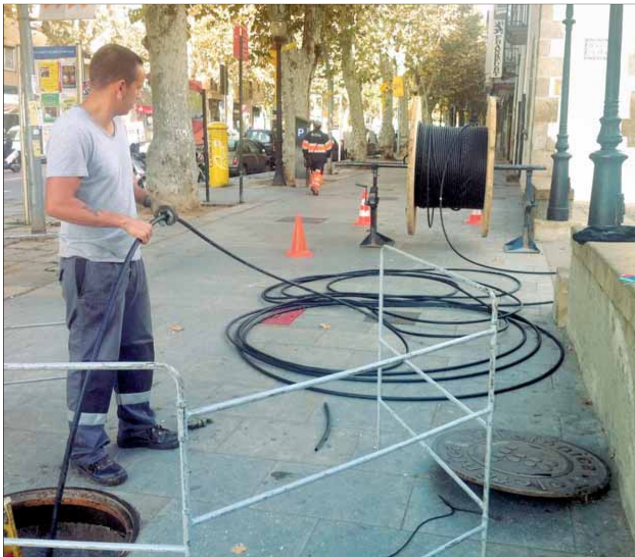
Operaris desplegant el cable, en aquest cas de Telefónica, l'estiu passat, a la riera d'Arenys de Mar ■ E.F.
