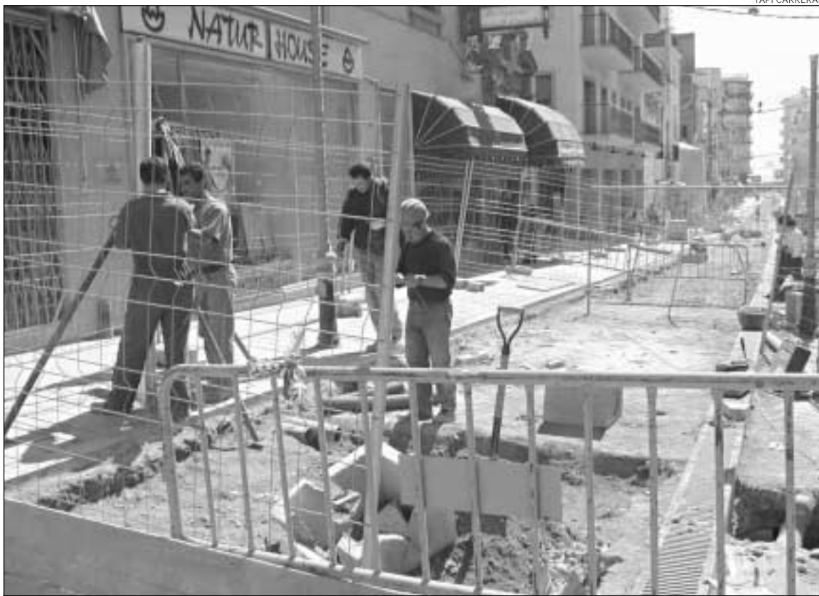
Treballant un dia festiu. Els operaris que estan reformant el carrer Ample no van parar ni ahir.
