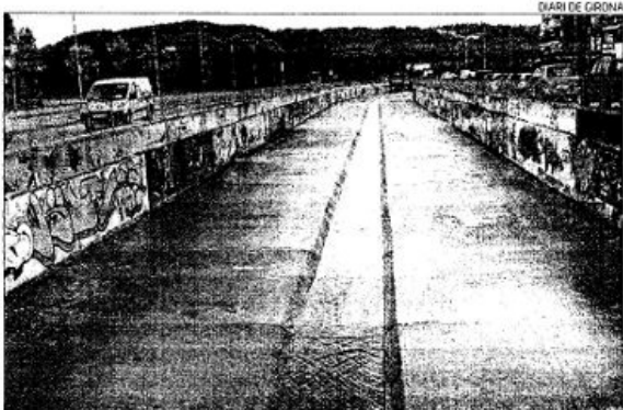
El canal de la riera de Lloret després de l'actuació de l'Ajuntament.
