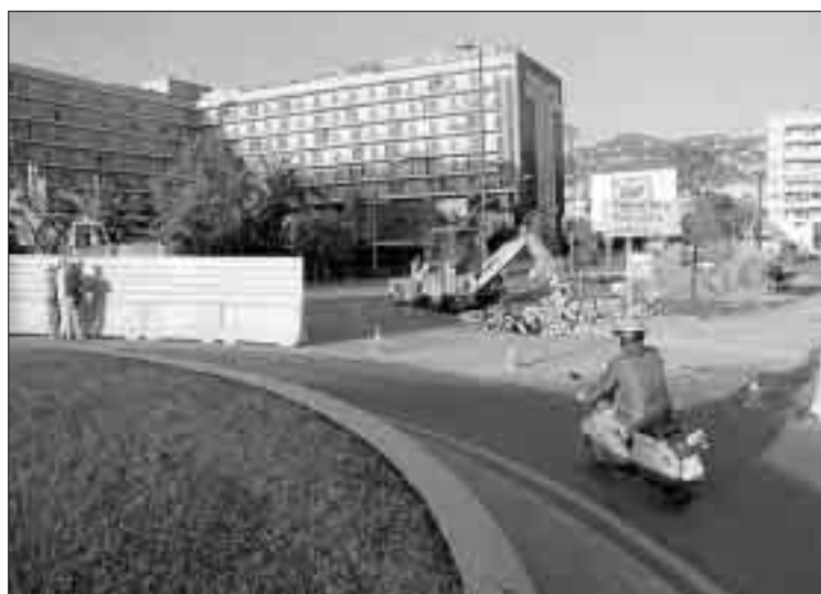
OBRES. La rotonda de l'avinguda Just Marlés ha quedat afectada.
